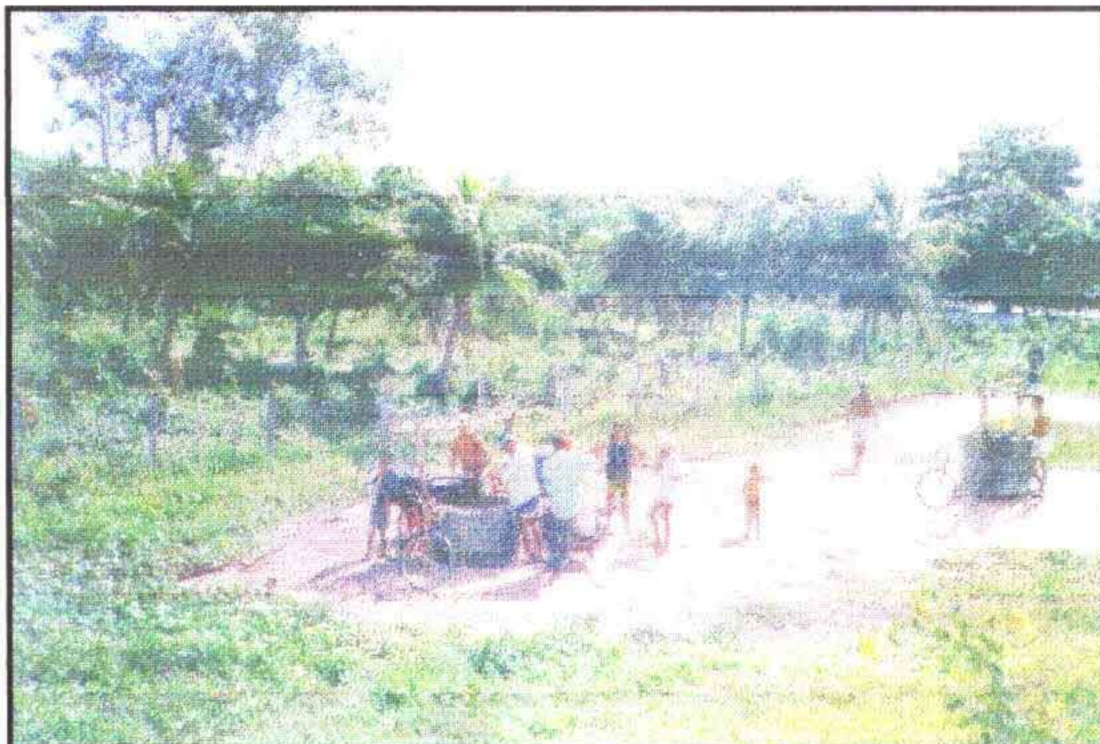
Foto 05 – Vista dos poços amazonas (cacimbões) que atualmente são utilizados para abastecer o distrito de Triângulo de Quixadá.
